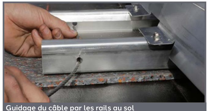
Guidage du câble par les rails au sol
