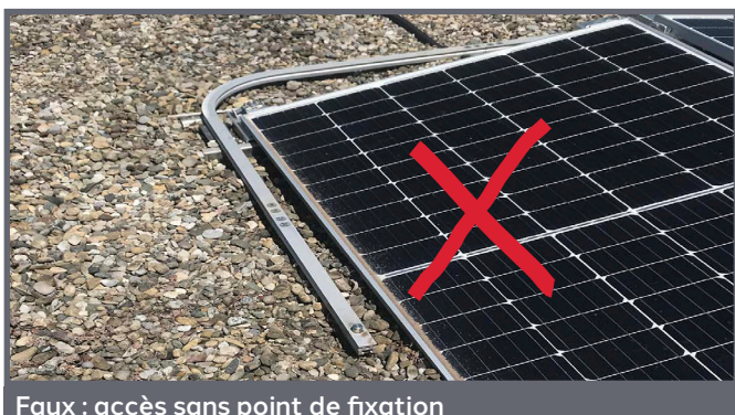
Faux : accès sans point de fixation
