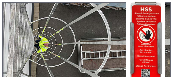
Le panneau d'avertissement doit être placé sur l'accès au toit.
