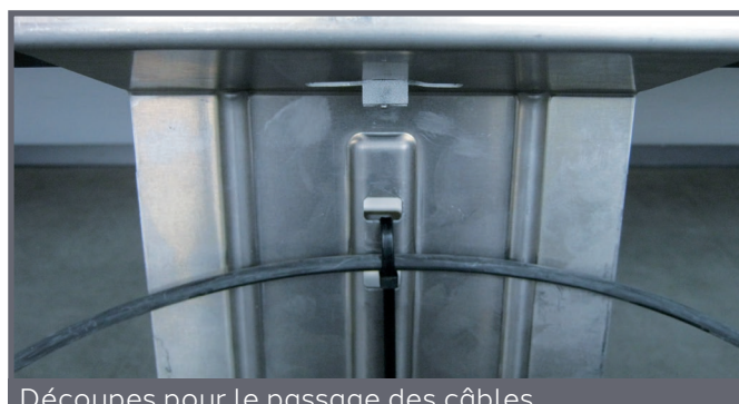
Découpes pour le passage des câbles
