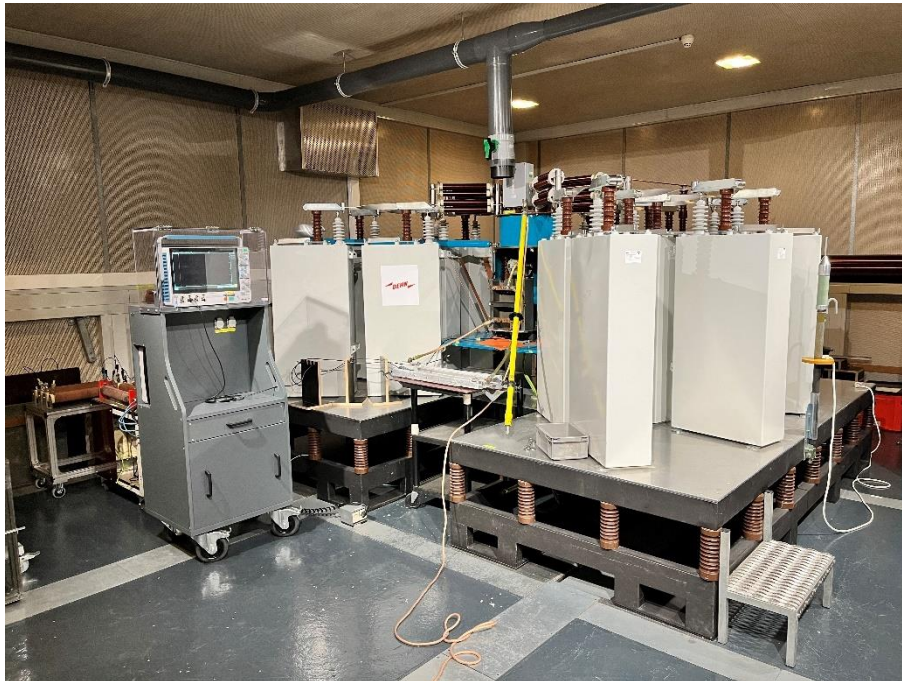
Bild 9: Elektrische Prüfung – Gesamtansicht des Aufbaus im 50 kA (10/350 µs) Impulsstrom Generator.
