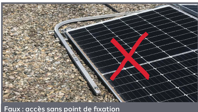
Faux : accès sans point de fixation
