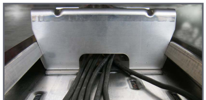
Bodenschiene als Kabelkanal für die Stringkabel genutzt
