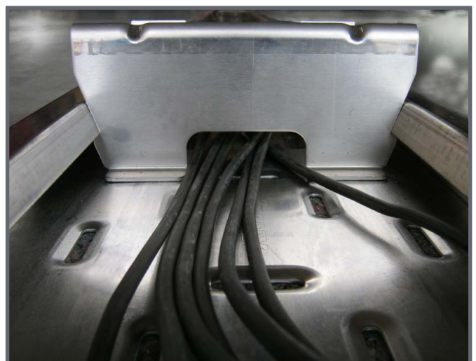
Bodenschiene als Kabelkanal für die Stringkabel genutzt
