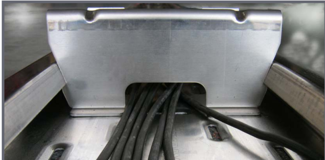
Bodenschiene als Kabelkanal für die Stringkabel genutzt
