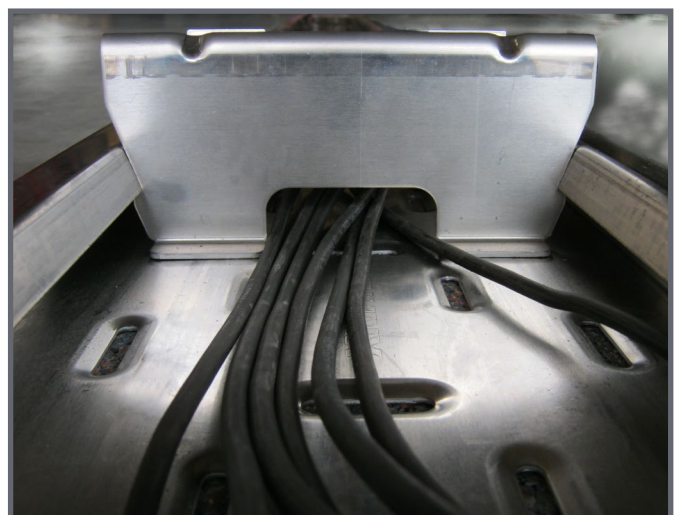
Bodenschiene als Kabelkanal für die Stringkabel genutzt
